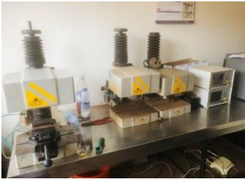
Image 13 : Les trois machines en panne en Ouganda.
