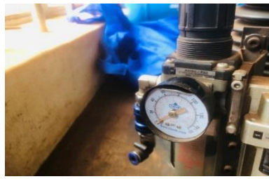
Indicateur de pression endommagé pour l'une des machines en panne en Ouganda
